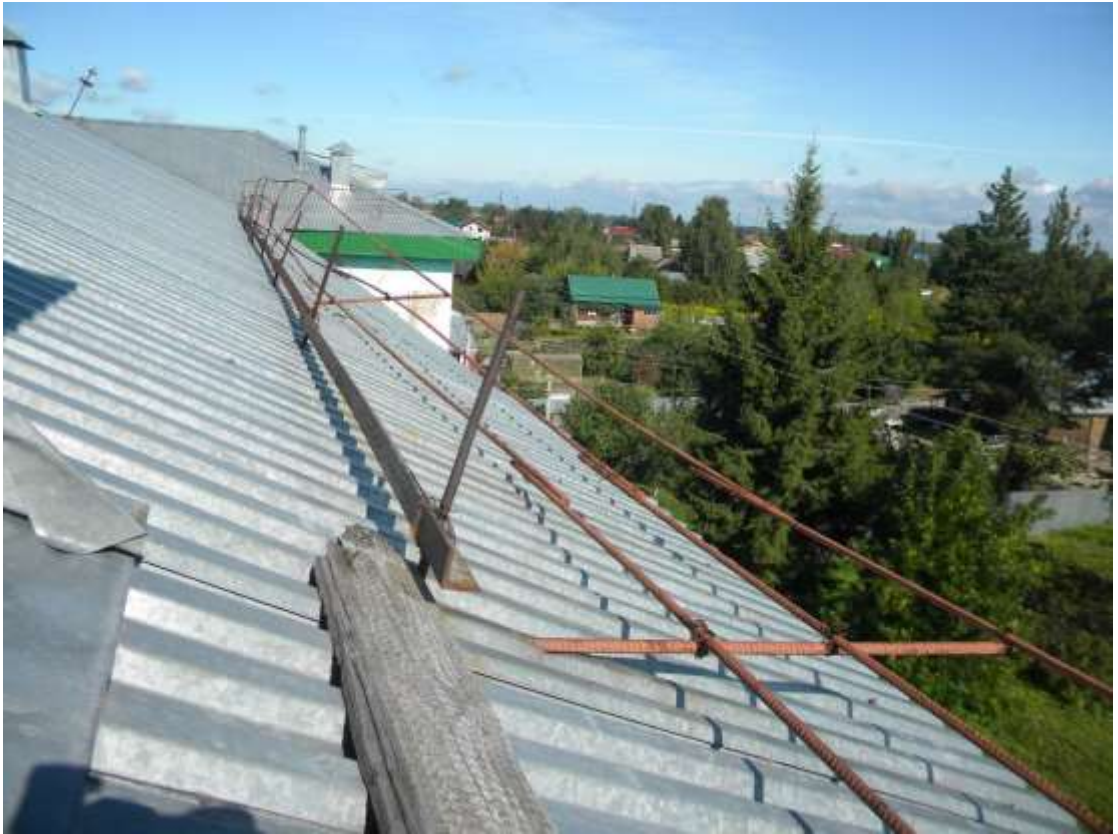
Фото №14 - Общий вид поврежденного кровельного ограждения
