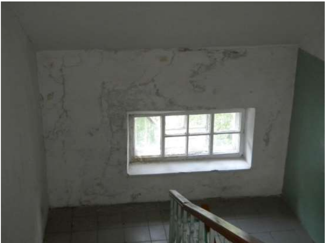
Фото №32 – Состояние наружных стен лестничной клетки в месте протечки
