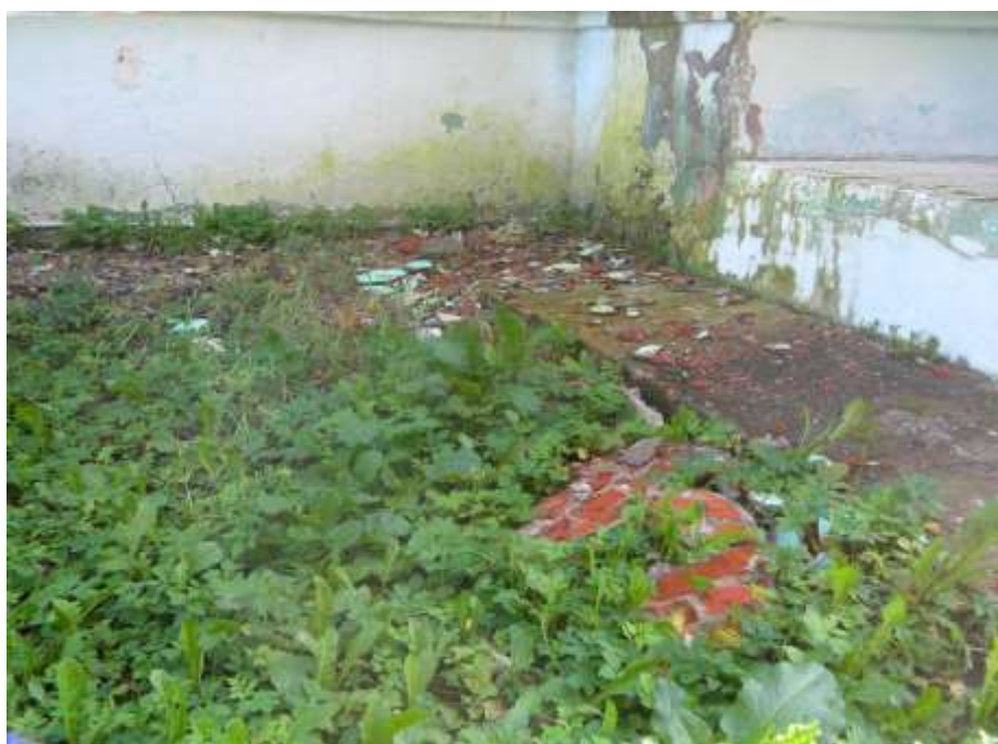
Фото №6 - Обрушение штукатурки и кирпичной кладки
