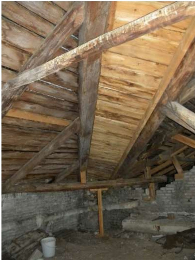
Фото №20 – Кладка наружной стены с морозной деструкцией (со стороны чердака)
