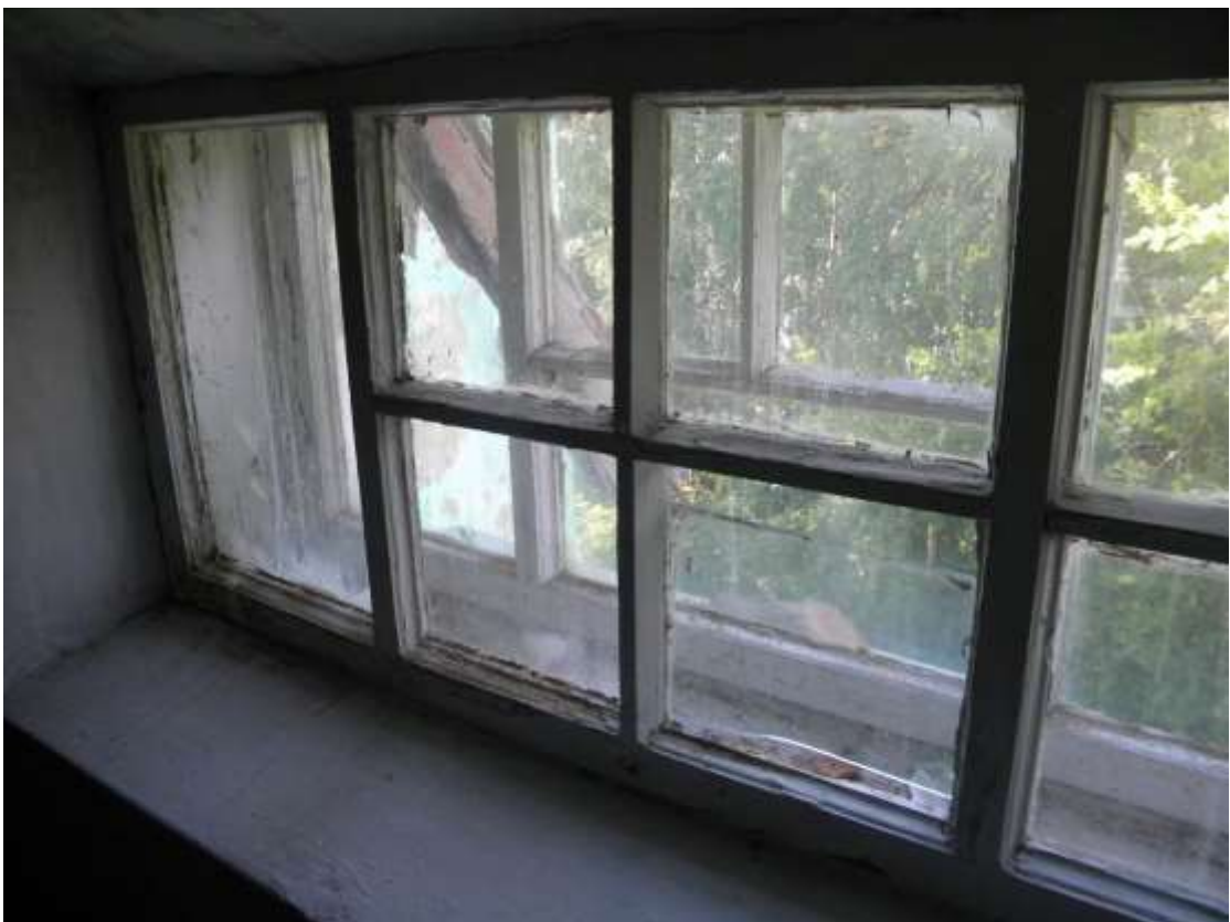
Фото №33 – Состояние деревянного оконного блока лестничной клетки в месте протечки
