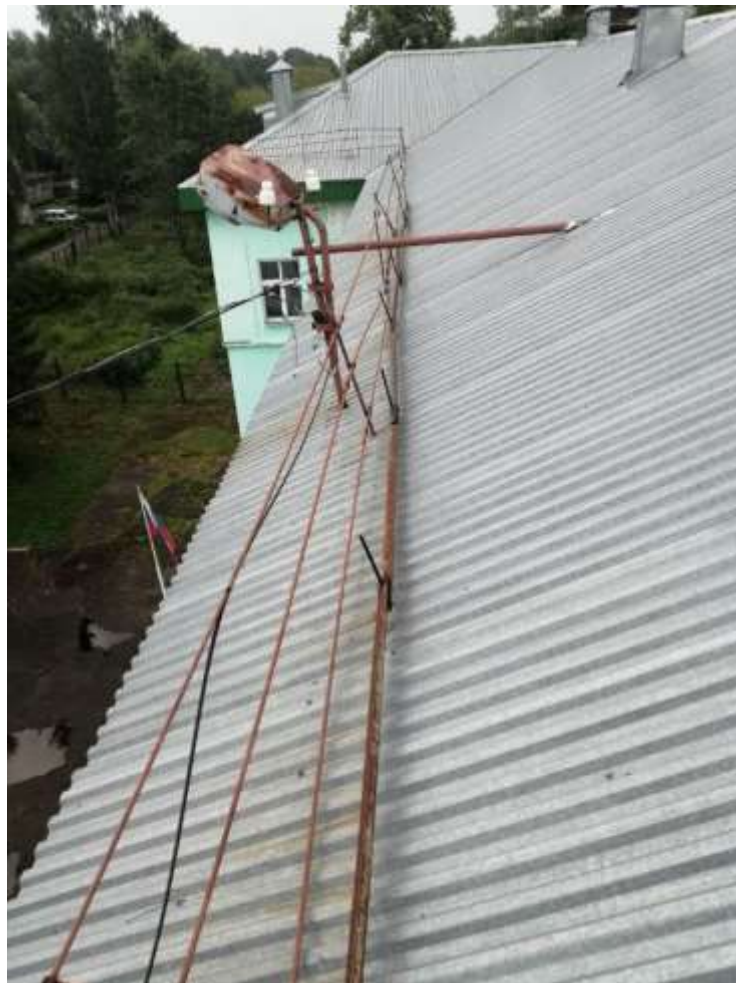
Фото №15 – Общий вид поврежденного кровельного ограждения
