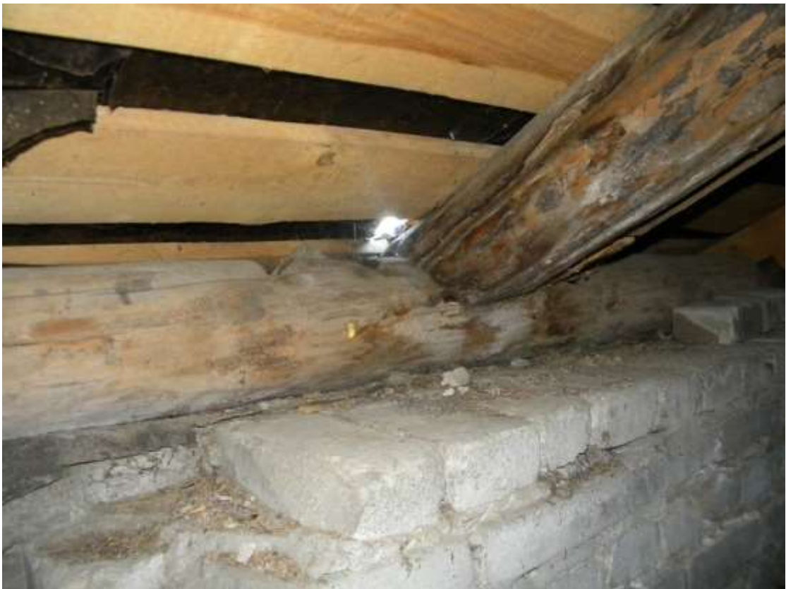
Фото №29 – Сквозные отверстия в покрытии кровли
