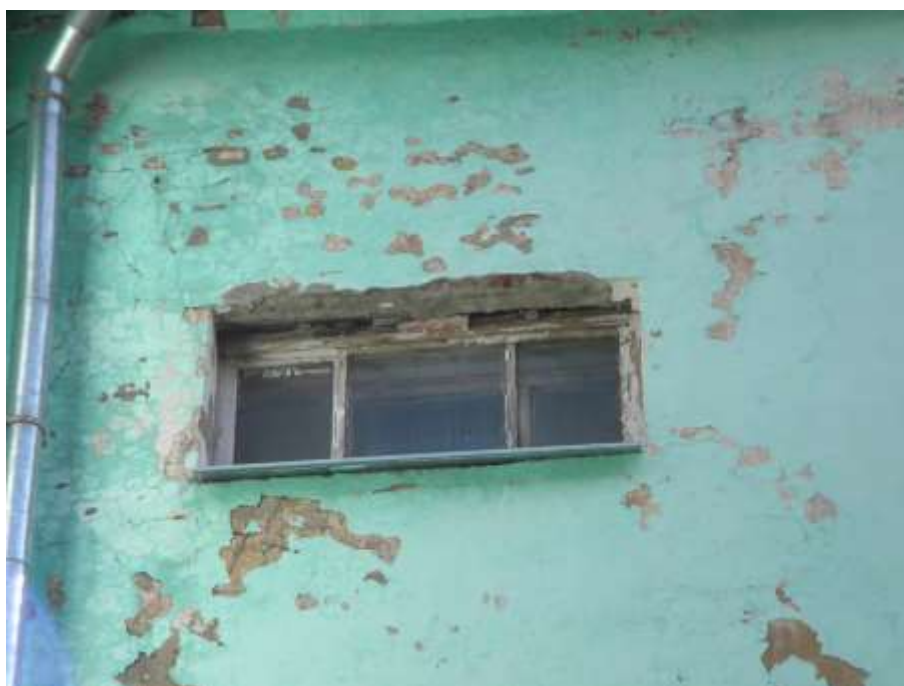
Фото №10 – Разрушение перемычки из прутков арматуры над оконным проемом лестничной клетки №2
