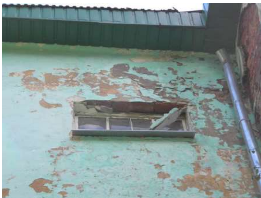
Фото №8 – Разрушение перемычки из прутков арматуры над оконным проемом лестничной клетки №1
