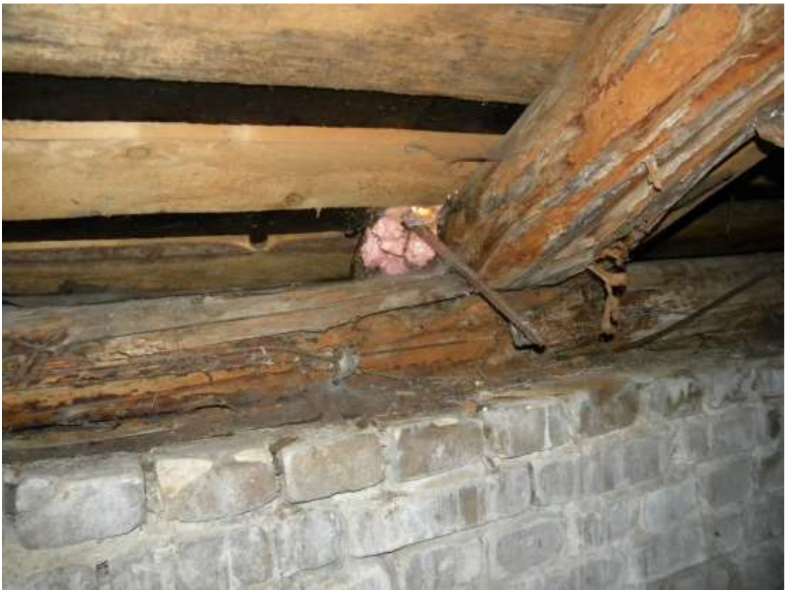
Фото №26 - Крепление стойки кровельного ограждения выполнено с нарушениями
