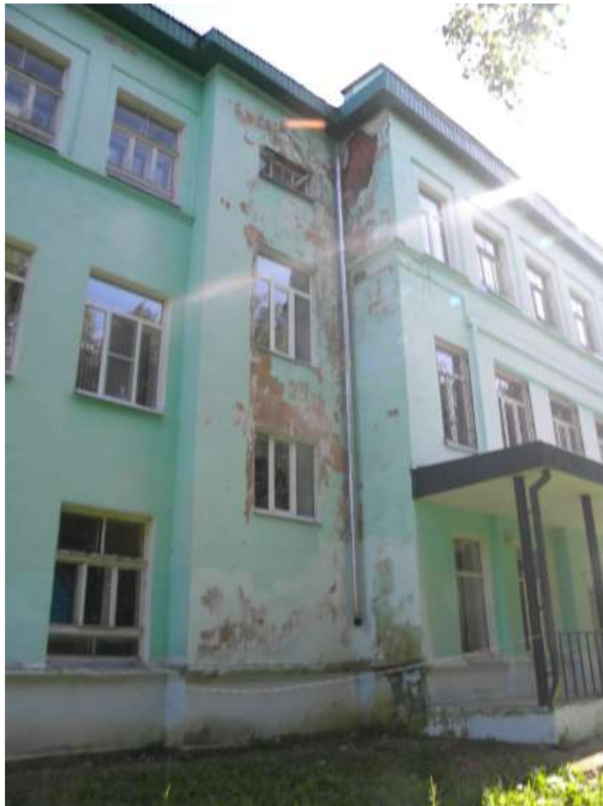
Фото №5 - Намокание стены лестничной клетки №1 ввиду неправильного выполнения водостока
