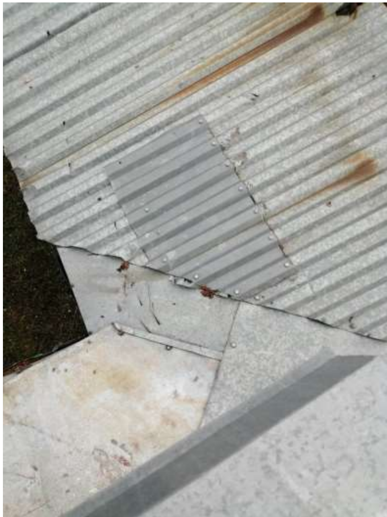
Фото №18 – Покрытие выполнено с грубыми нарушениями
