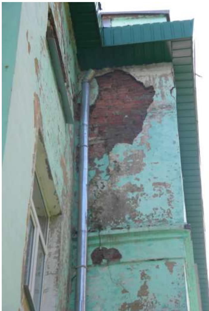
Фото №7 – Морозная деструкция штукатурки и кладки стены лестничной клетки №1
